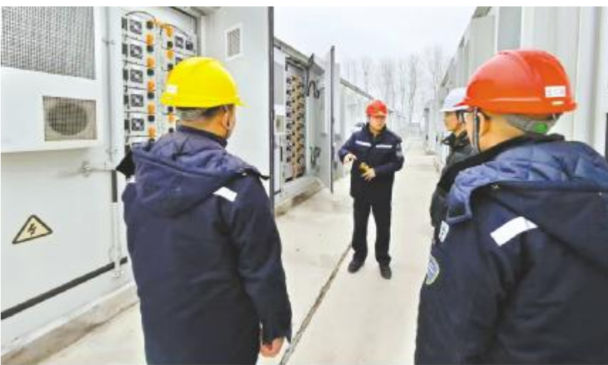
巡检设备,消除隐患
